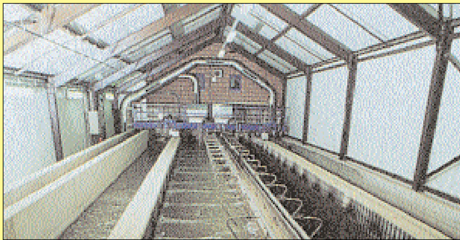
Il s'agit d'une station d'épuration biologique classique avec une unité de dessablement et de séparation des huiles, trois bassins de décantation primaire et une unité de traitement biologique.
